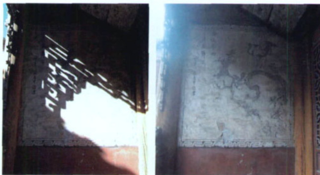
4 廊心墙“松鹤遐龄”壁画现状(左:晴天摄,右:雨雾天摄)
