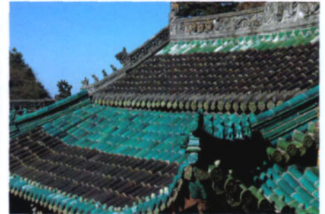
17 檐廊屋顶后增筑接合缝隙情况
